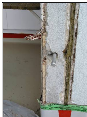
Eingelegte Profile (rechts) stark korrodiert.
