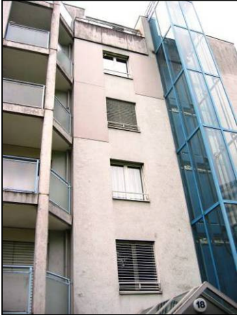
Situation vor Auftragsannahme: Die Fassade ist mit Eternit- platten als Wassersperre abgedeckt (Wasseraustritt gestoppt).
