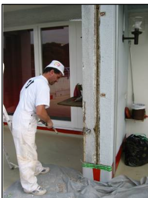
Wasser in Mauern, stark korrodierte Kantenprofile.
