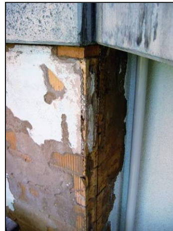
Die undichte Fuge an der Betonbrüstung (siehe oben im Bild) ist die Ursache des Schadens an der Fassade.
