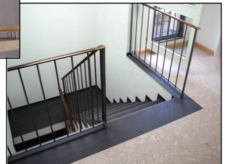
Treppenkanten gut ersichtlich durch Kontrast
